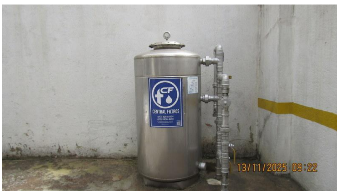
Foto 25 – Vista do filtro central de água.
