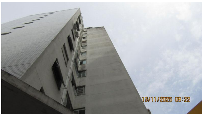
Foto 13 – Outra vista das fachadas de fundos do Condomínio do Edifício Di Franco.
