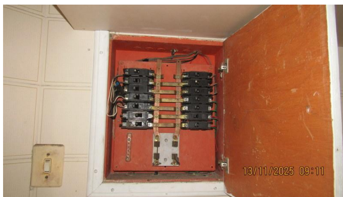
Foto 78 – Detalhes do quadro de distribuição de energia da unidade avalianda.
